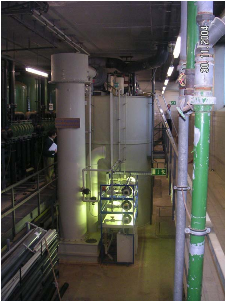
Foto 1: Installatie bij Hella met op de voorgrond UV reactoren, koeltoren en druppelvanger en in de achtergrond reactietank.
