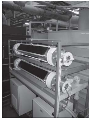
Foto 2: Cyanomat® voor de behandeling van complexe afvalwaters bij Seidel. Enviolet® -UV-oxidatie reactoren staan Voorin, alle andere componenten (opslag tanks, reactietank, energie Recuperatie, doseerstations, controlekast etc.) staan achterin
